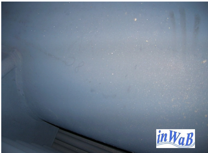
Flamm- und Rauchgasrohr von Kessel Mit inWaB Reinigungs- und Behandlungsprogramm Ablagerungen => KEINE grau-blaue Farbe => Metallpassivierungs-/ Korrosionsschutzschicht
